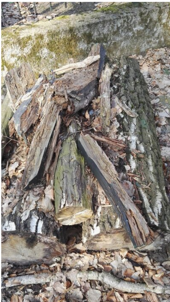
Krzyż przed wymianą, fot. UG Nowosolna
