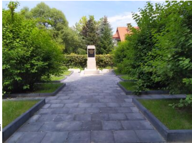
Kraków-Skotniki, lipiec 2020, remont cmentarza z II wojny światowej – cmentarz jeńców sowieckich wziętych do niewoli przez Niemców, remont przeprowadzony wspólnie z Małopolskim Urzędem Wojewódzkim. Fot. IPN
