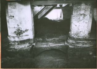
Ksiądz Rektor Ludwik Bajgrowicz zastaje kościół św. Jana w stanie opuszczenia. „Nie ma ani jednej kłódki, wbrew pozorom próżno szukać. Sklepienie to tylko wlotowy otwór, ledwo widoczny, a w ścianach miejscami wiszący kawałki do rozdzielenia próżno rozpoznaje się też cokolwiek. Widać tylko ścianki i słupki (Kronika szczecińskiego parafialnego SAC).
