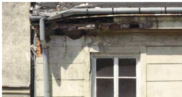
♦ Skutki „zamykania ściany” przed zakończeniem remontu
