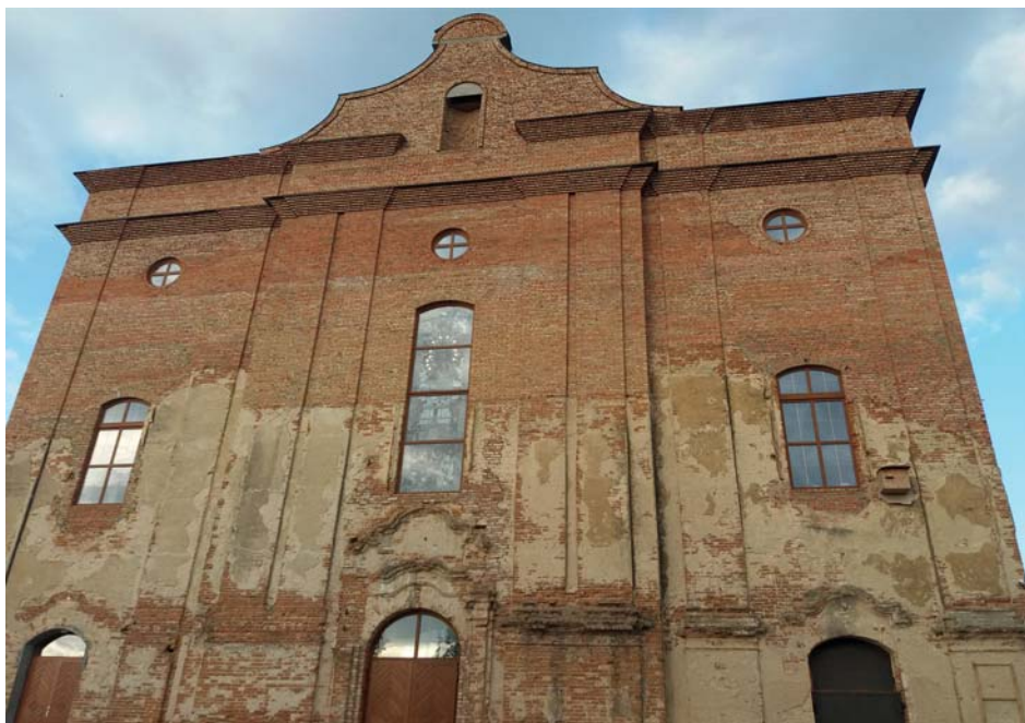
Fasada kościoła pw. św. Michała Archanioła w Tyrowie pozbawiona wież oraz elewacji, 2018 rok. Fot. Adam Hlebowicz
