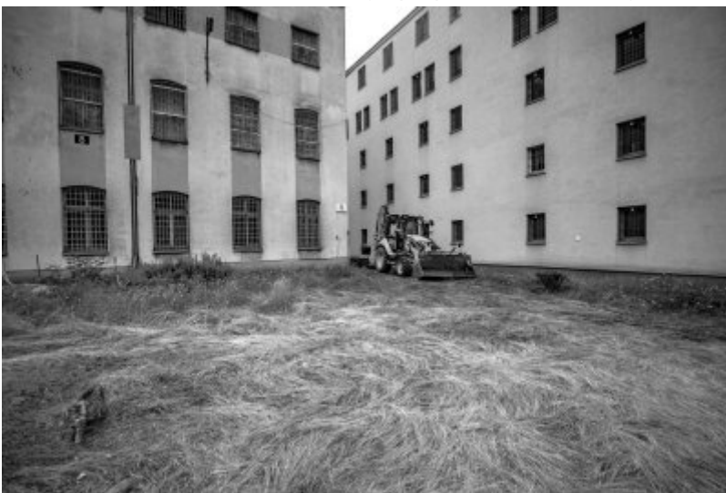
BPil wznowiło prace na terenie dawnego Aresztu Śledczego przy ul. Rakowieckiej w Warszawie - 11 czerwca 2018
